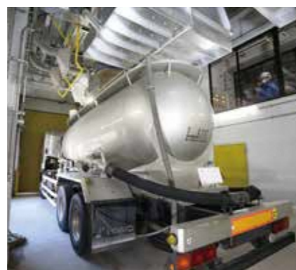
灰積出室 灰バンカに貯留した灰を飛散させることなく車両に積載し搬出することができます。
