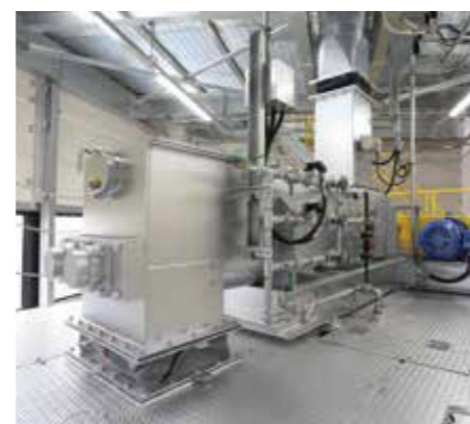
灰混練機 灰に薬剤を加えて混ぜ込むことで重金属類の溶出を防止することができる設備です。
