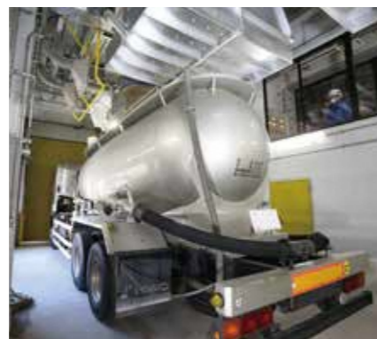
灰積出室 灰バンカに貯留した灰を飛散させることなく車両に積載し搬出することができます。
