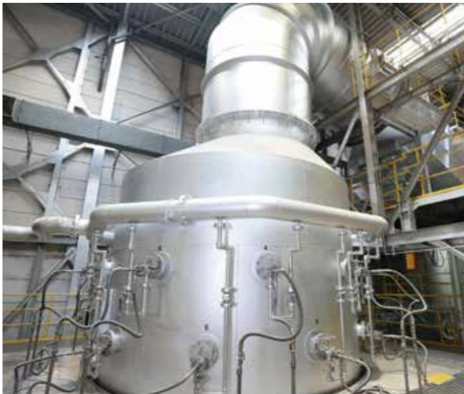
ガス冷却室 焼却炉の高温の排ガスを冷却水噴霧によって冷却する設備です。冷却水は工場内から発生する汚水を薬剤処理したうえで再利用しています。
