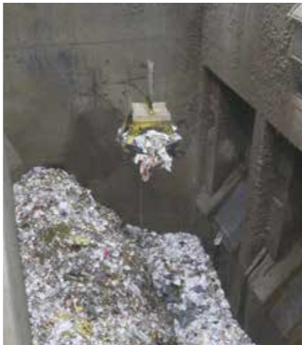
ごみピット 収集されたごみを貯留し、攪拌、均一化する設備です。
