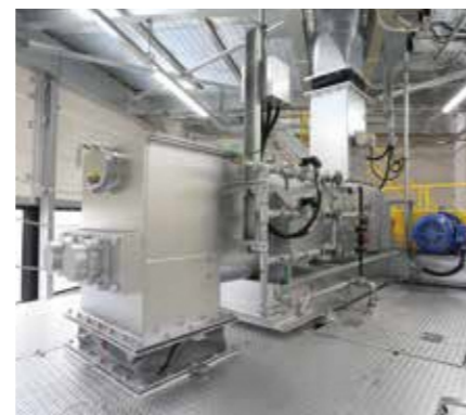
灰混練機 灰に薬剤を加えて混ぜ込むことで重金属類の溶出を防止することができる設備です。
