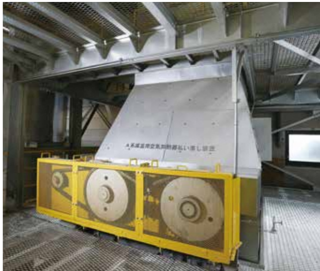
減温用空気加熱器 ガス冷却室を通過した排ガスをさらに冷却する設備です。2,508本の伝熱管に工場内の空気を通すことにより熱交換し排ガス冷却を行います。
