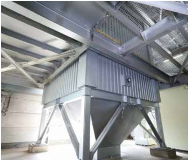
触媒脱硝塔 集じん装置を通過した排ガスをさらに処理する設備です。蜂の巣状の触媒が3層に設置されており、この触媒を通過させることでダイオキシン類や窒素酸化物の分解除去が可能となっています。
