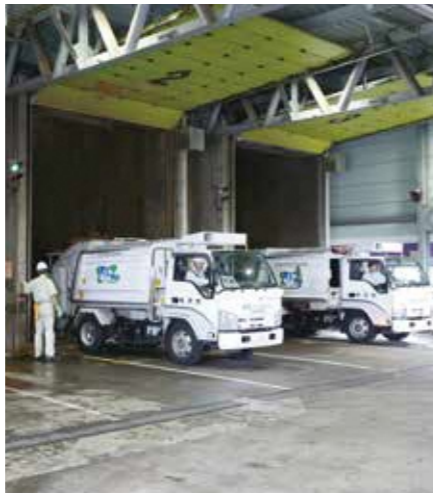
プラットフォーム ごみ収集車等で集められたごみをごみピットへ投入する場所で、投入扉が3箇所あります。
