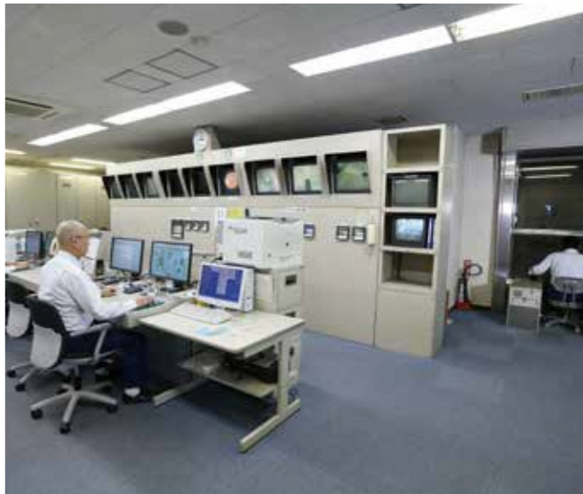
中央操作室 焼却施設の運営に関する全てのデータを集中管理する場所です。焼却炉の監視のほか、クレーンの操作を行っています。
