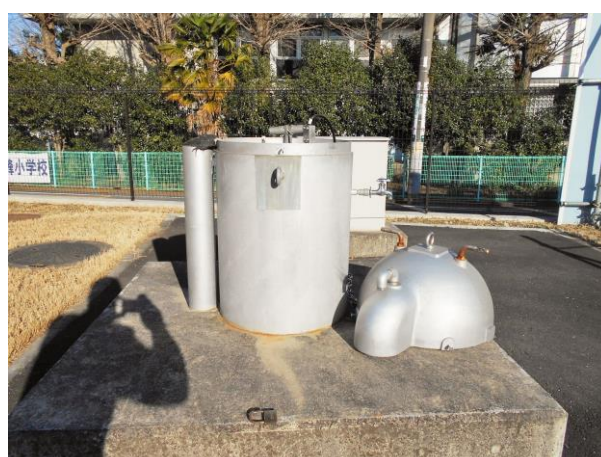
第一浄水場内取水井（第2号取水井）
