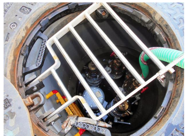
耐震性貯水槽の給水室部分
