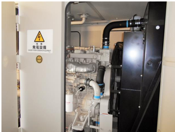
自家発電装置 (第一浄水場)
